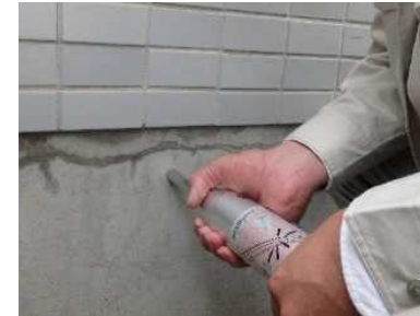
リバウンドハンマーを用いたコンクリートの圧縮強度の測定
