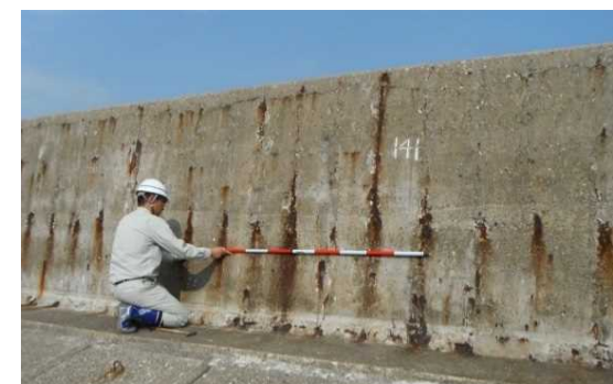
老朽化状況(コンクリート劣化・鉄筋露出)
