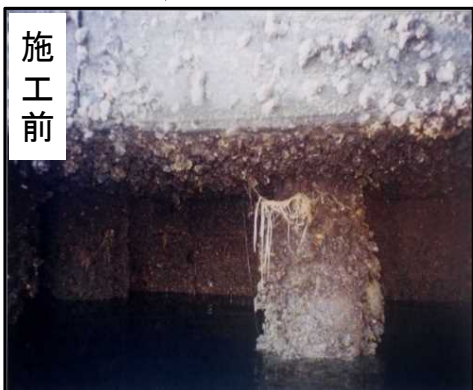
鋼管杭が塩害により腐食
