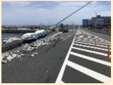
台風時の船舶衝突により被災した横浜港はま道路
