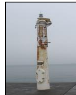
〔外装塗装剥離状態〕
