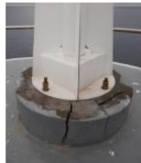
〔灯台基部コンクリートの亀裂状況〕
