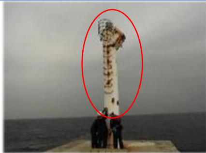
〔灯台本体の腐食・汚損状況〕
