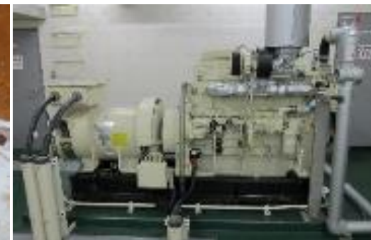
〔老朽化した非常用発電機〕
