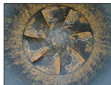
腐食した排水ポンプ場の羽根車
