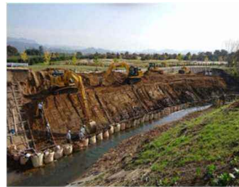
令和元年東日本台風時の国による権限代行の例（阿武隈川水系滝川）
