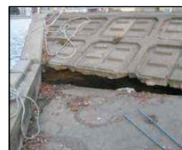
クラックが生じた河川護岸
