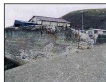
老朽化した海岸堤防
