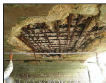
内部の鉄筋が露出した橋梁
