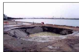
陥没した港湾施設のエプロン部分
