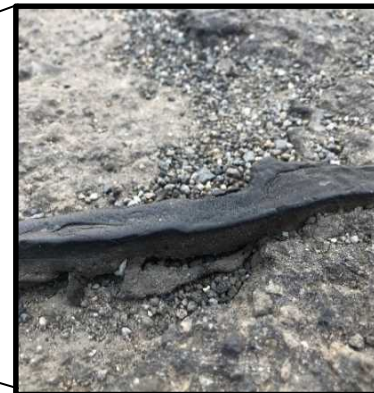
電磁誘導線の損傷等を確認
