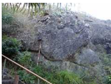
急傾斜地の落石危険箇所
