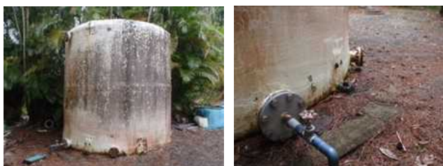
昭和47年に設置され、経年劣化により漏水が発生しているFRP水槽
