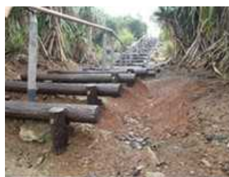
階段：降雨による洗掘
