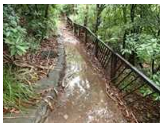
園路：雨水排水の不良
