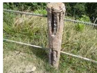
転落防止柵：老朽化
