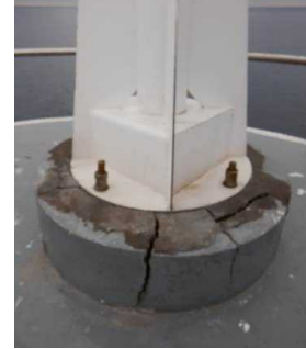
〔灯台基部コンクリートの亀裂状況〕
