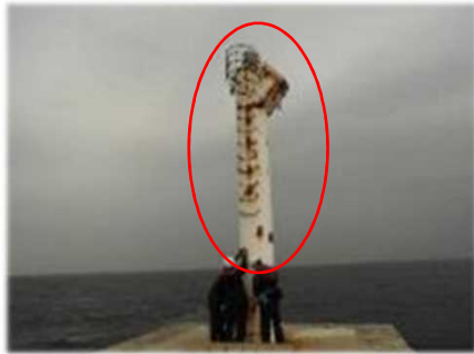
〔灯台本体の腐食・汚損状況〕
