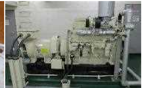
〔老朽化した非常用発電機〕
