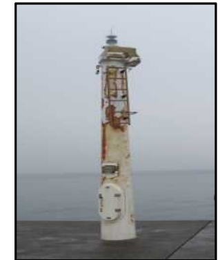
〔外装塗装剥離状態〕
