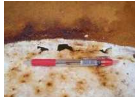
〔灯台内部孔食・亀裂状況〕
