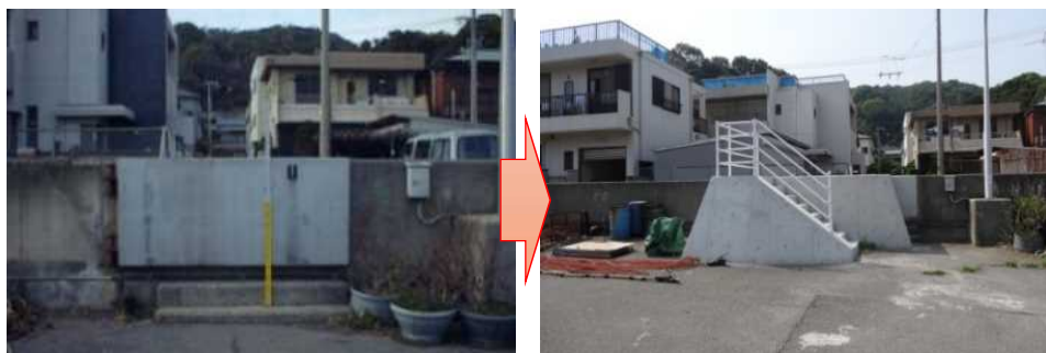
陸閘を廃止し、近接した場所に階段を設け、利便性を確保
