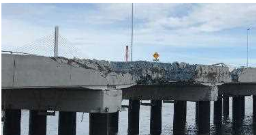
＜横浜港 南本牧はま道路の損傷＞
