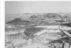
流水等により破壊された家屋(昭和27年 十勝沖地震) 資料提供:浜中町役場
