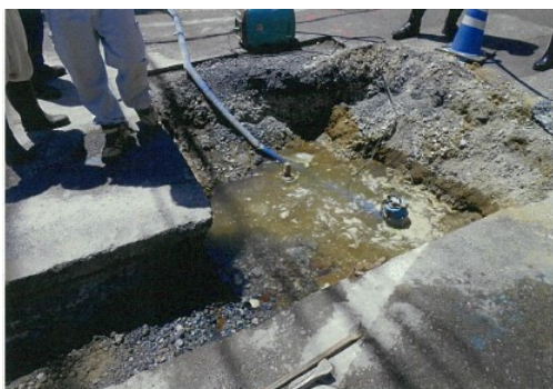
漏水状況 (千葉県工業用水道)
