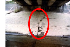
コンクリートの損傷
