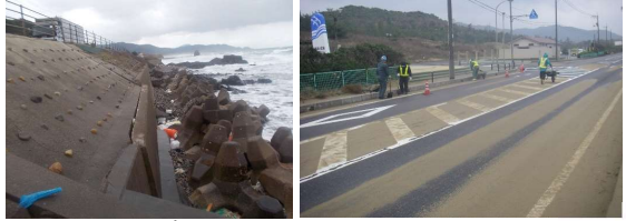
写真1 海岸浸食に伴う、転倒の恐れのある擁壁 写真2 冬の飛砂及び滞砂
