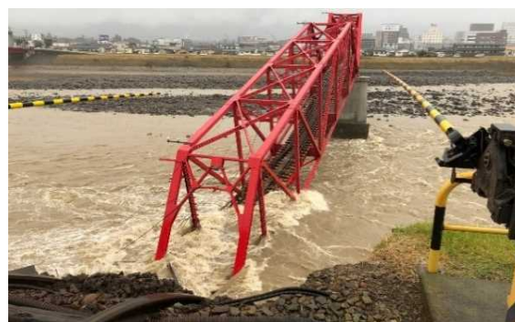
千曲川桥梁崩落状況（長野県上田市）
