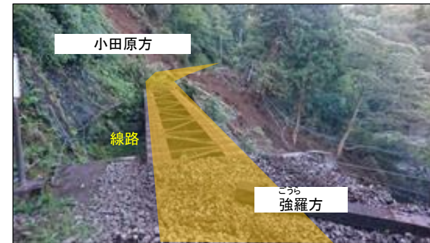
・箱根登山鉄道(宮ノ下～小涌谷):橋桁流失
