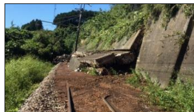
・JR東日本 中央線(高尾～相模湖):擁壁崩壊 13
