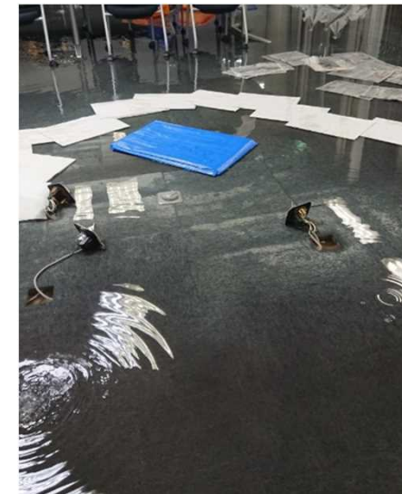
北部事務所 浸水状況
