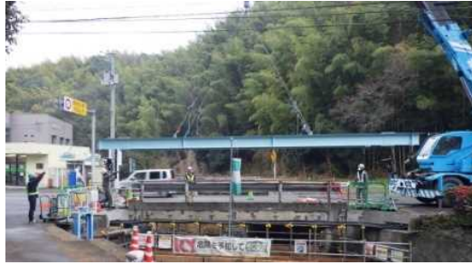
クレーンで主桁を撤去して支承を補修 主桁は工場で補修し再架設
