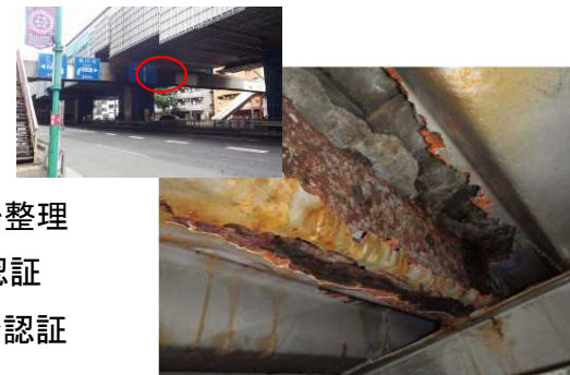
デッキ内部に溜まった水による鋼板の腐食・欠損
