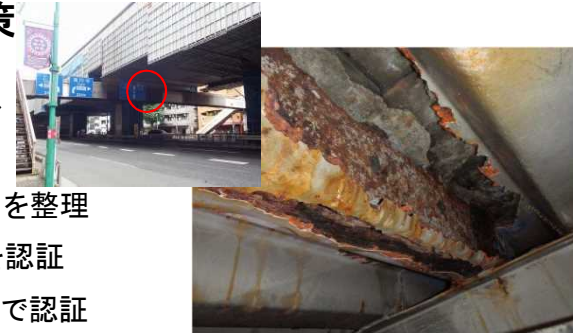
デッキ内部に溜まった水による鋼板の腐食・欠損
