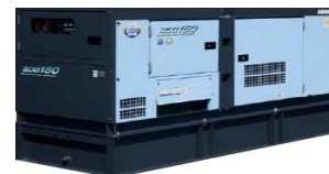
非常用電源設備
