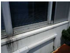
建具劣化状況
