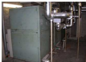
空気調和機劣化状況
