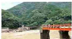
令和2年7月豪雨、熊本県道
