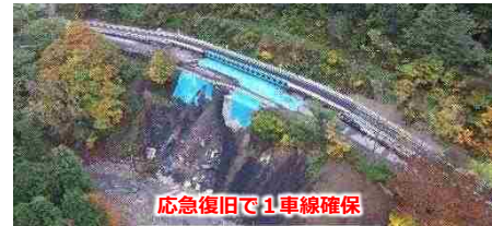
令和4年8月の大雨 （国道121号：山形県）
