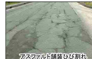
アスファルト舗装ひび割れ
