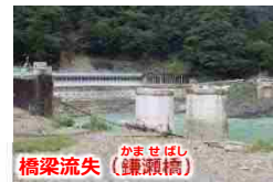
橋梁流失 （鎌瀬橋）
