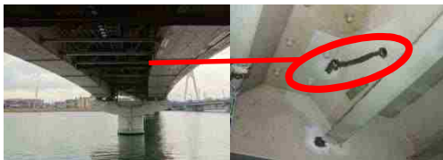
縦リブ等に多数の疲労亀裂が発生
