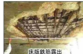
床版鉄筋露出
