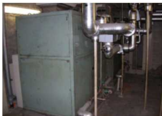
空気調和機劣化状況
