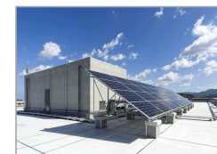
再生可能エネルギー施設 (太陽光発電施設 等)
