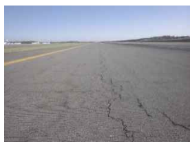
(舗装のひび割れが発生)
