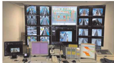
<監視サーバー等>
