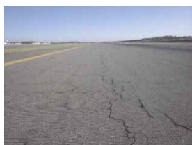
(舗装のひび割れが発生)
