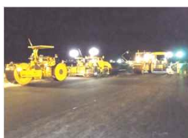
(老朽化した滑走路舗装の改良)
