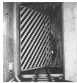
防水扉(トンネル内)
