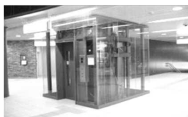
エレベーター
