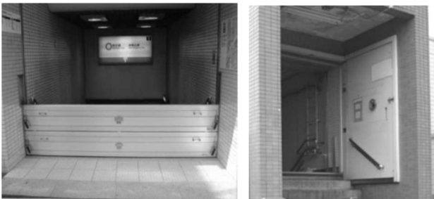
止水板・防水扉の整備
