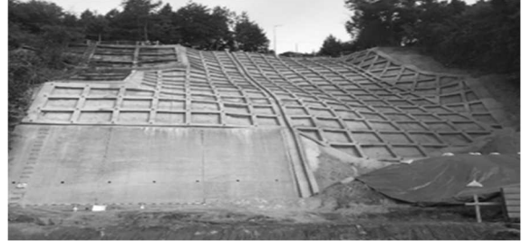
コンクリート枠による斜面の補強
