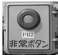
非常押しボタン
