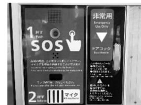
非常通報装置と非常用ドアロックを一体的に案内している例
