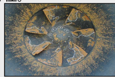
腐食した排水ポンプ場の羽根車
