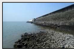
老朽化した海岸堤防
