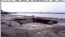
陥没した港湾施設のエプロン部
