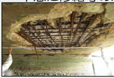
内部の鉄筋が露出した橋梁
