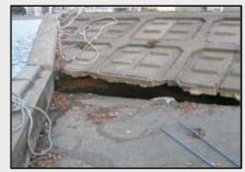
クラックが生じた河川護岸
