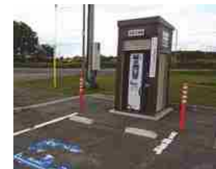
道の駅「もち米の里☆なよろ」のEV充電器
