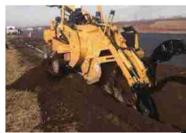
トレンチャー機械による掘削の試験施工 （寒地土木研究所 苫小牧寒地試験道路）
