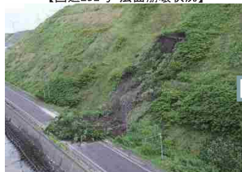
【国道232号 法面崩壊状況】
