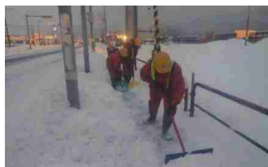
電柱により歩道が狭い箇所は人力で除雪するため作業効率低下 （苫小牧市 国道36号）
