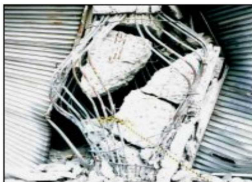
店舗1階柱の圧壊
