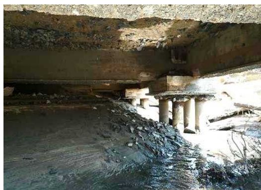
建物基礎が露出
