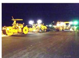
(老朽化した滑走路舗装の改良)
