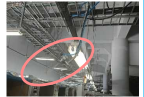
ランプサイドの空調装置(ミスト) (中部空港)
