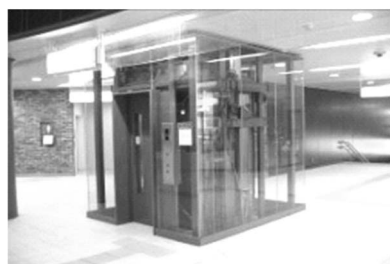
エレベーター
