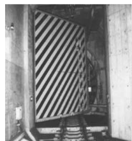
防水扉(トンネル内)
