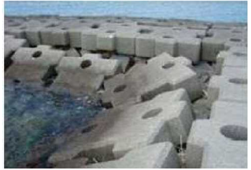
突堤の被覆ブロックの散乱事例
