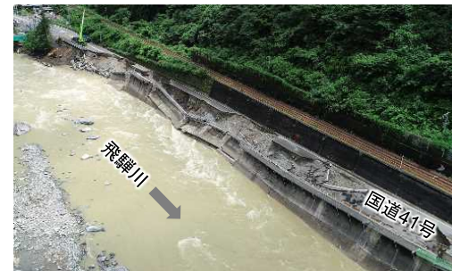
国道41号 道路崩壊 (岐阜県下呂市)
