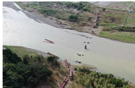
くま川鉄道 球磨川第4橋梁 橋梁流失(熊本県球磨郡相良村-錦町)
