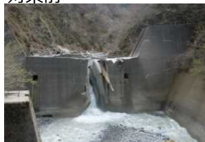
常時流水の影響による摩耗の進行
