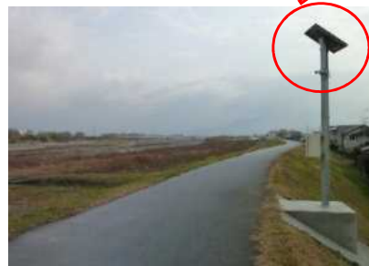
簡易型河川監視カメラ
