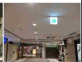
避難誘導施設の整備
