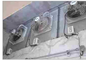
大規模換気設備
