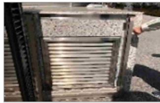
地下街の換気設備開口
