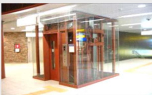
段差の解消 (エレベーター)
