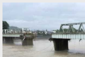
西瀬橋の被災状況
