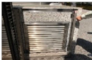
地下街の換気設備口
