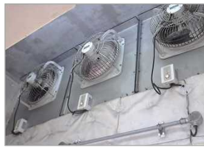
大規模換気設備
