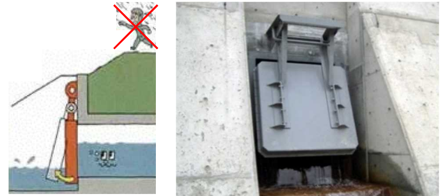
フラップゲート(操作員による扉の開閉が不要)
