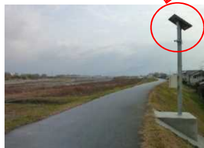
簡易型河川監視カメラ
