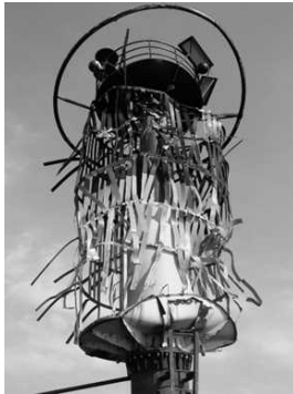
損傷した施設
