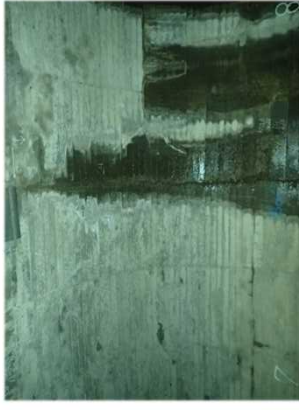
損傷状況(うき・漏水)
