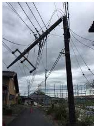
千葉県内の 暴風による被害
