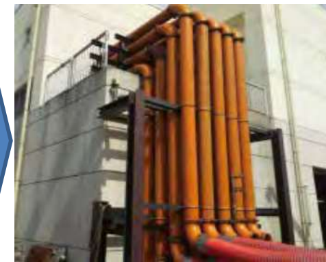
代替機能を確保した例 (480m 3 /時×20台のポンプを設置)
