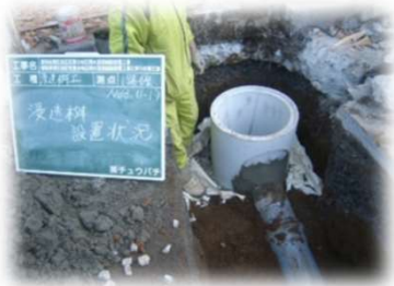
雨水浸透ます
