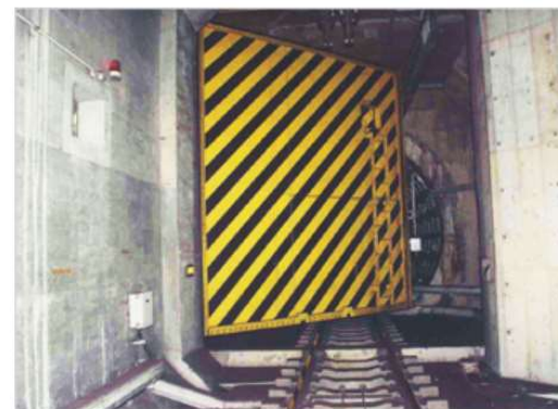
トンネル内防水ゲート
