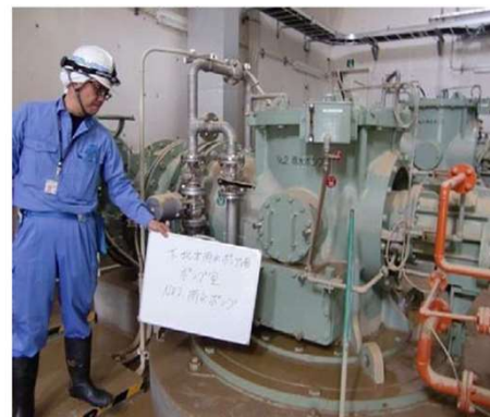
浸水した雨水ポンプ
