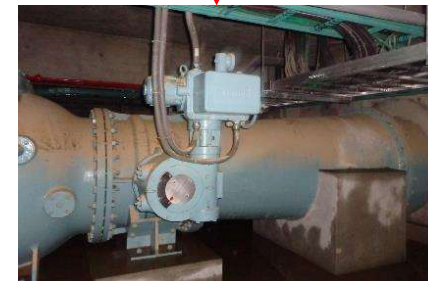
被災したポンプ吐出弁電動機
