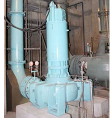
設備機器の防水化 (耐水化モーター)
