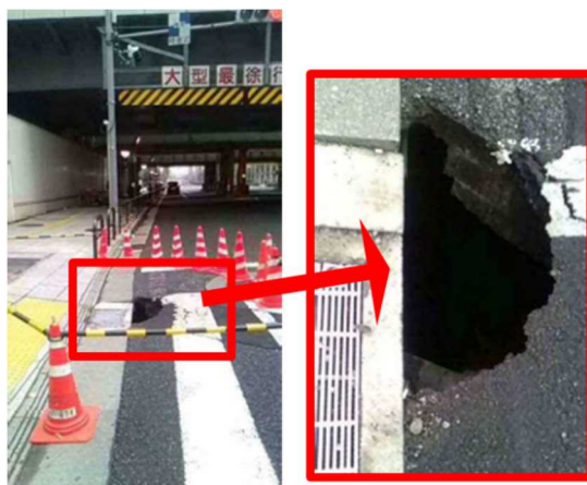
図 5.4 ビルピット排水由来の硫化水素による道路陥没事故（令和 2 年）
