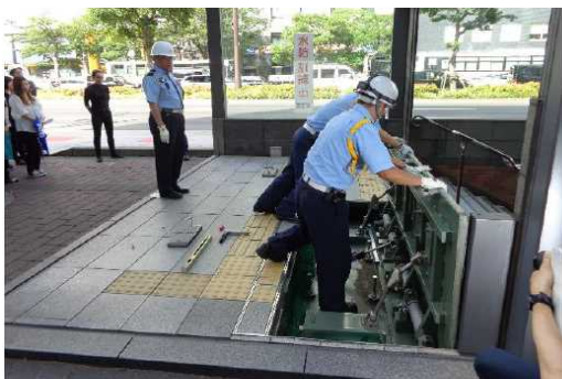
手動起上式止水板設置
