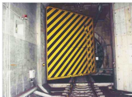
トンネル内防水ゲート
