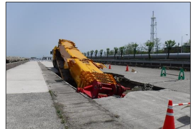
＜埋立護岸の背面土砂吸出しによる陥没事故＞
