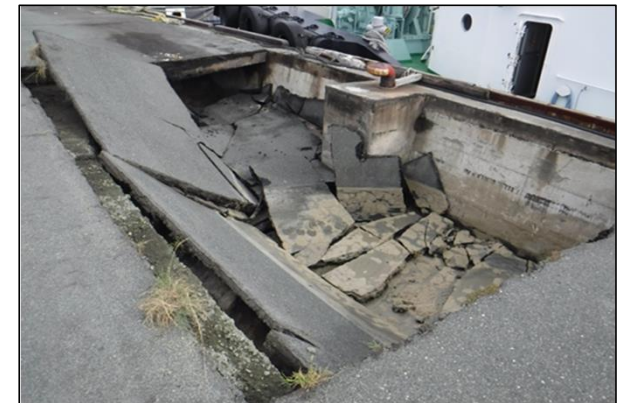
＜岸壁の背面土砂吸出しによる陥没事故＞
