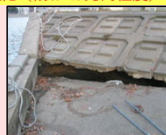
クラックが生じた河川護岸
