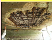
内部の鉄筋が露出した橋梁
