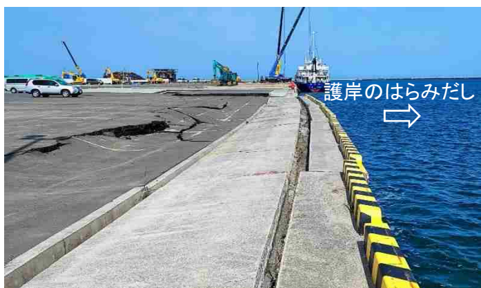
護岸の被災[相馬港(福島県)]
