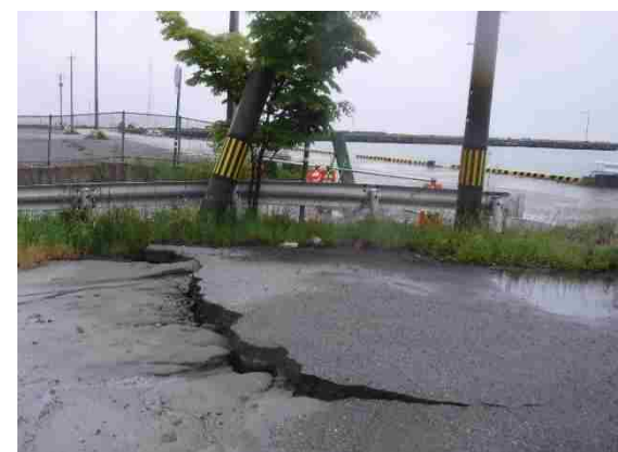
臨港交通施設の被災[飯田港(石川県)]
