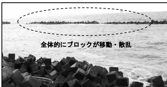
離岸堤の老朽化が進行しているイメージ
