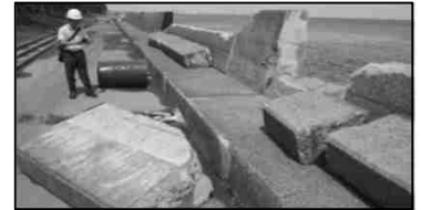
高波による護岸倒壊 (令和元年房総半島台風での横浜港の事例)
