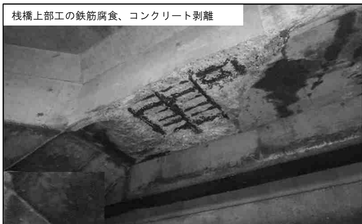
老朽化の進行の事例（広島港）
