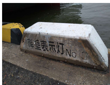
破断で接触した岸壁照明カバー
