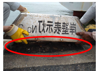
根本が劣化もあって破損
