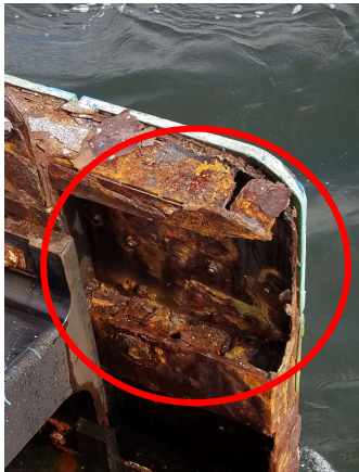
防舷材の経年劣化 ①
