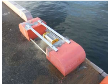
形だけの岸壁照明カバー②
