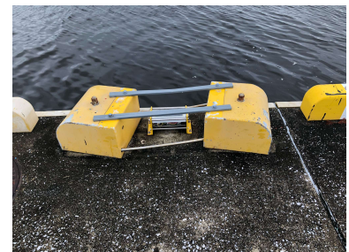
岸壁照明の破損
