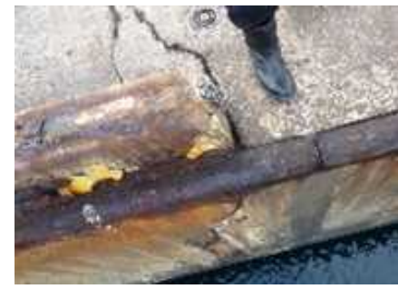
上部コンクリートのひび割れ
