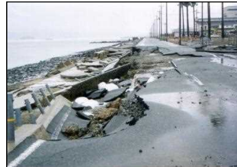
平成11年台風18号による護岸などの倒壊
