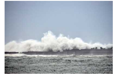
台風による防波堤の越波 (写真提供：高松港湾・空港整備事務所)
